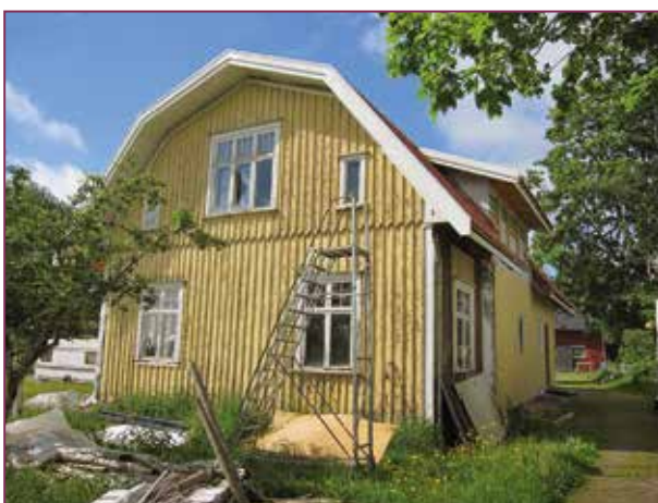
Illustration 32. Här pågår en utvändigt tilläggsisolering av väggar och byte av fönster. Byggnaden utvärderades inte som kulturhistoriskt värdefull vid 1974 års inventering, däremot vid den uppdatering som gjordes 2007.
