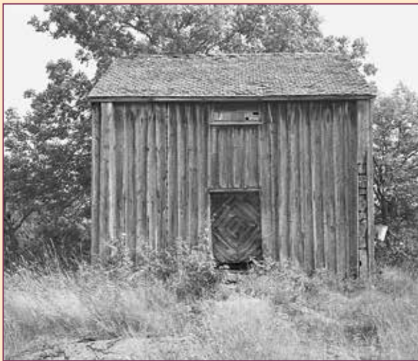
Illustration 82. Numera riven bod i Håbol, ingick i grupp IV. De små dalsländska sädesmagasinen i två våningar hör till de ekonomibyggnader som förlorat sin ursprungliga funktion för länge sedan.
